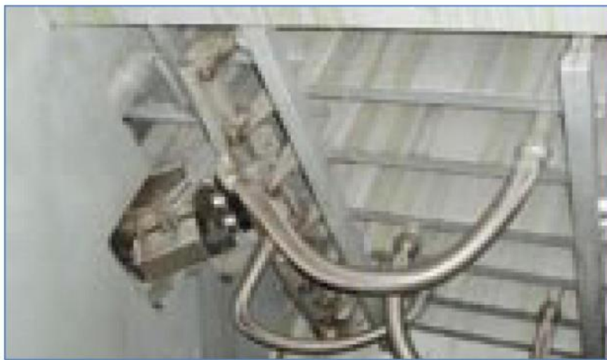
شکل ۲. واحدهای درایو نصب شده در قسمت خارجی سگمنت.
