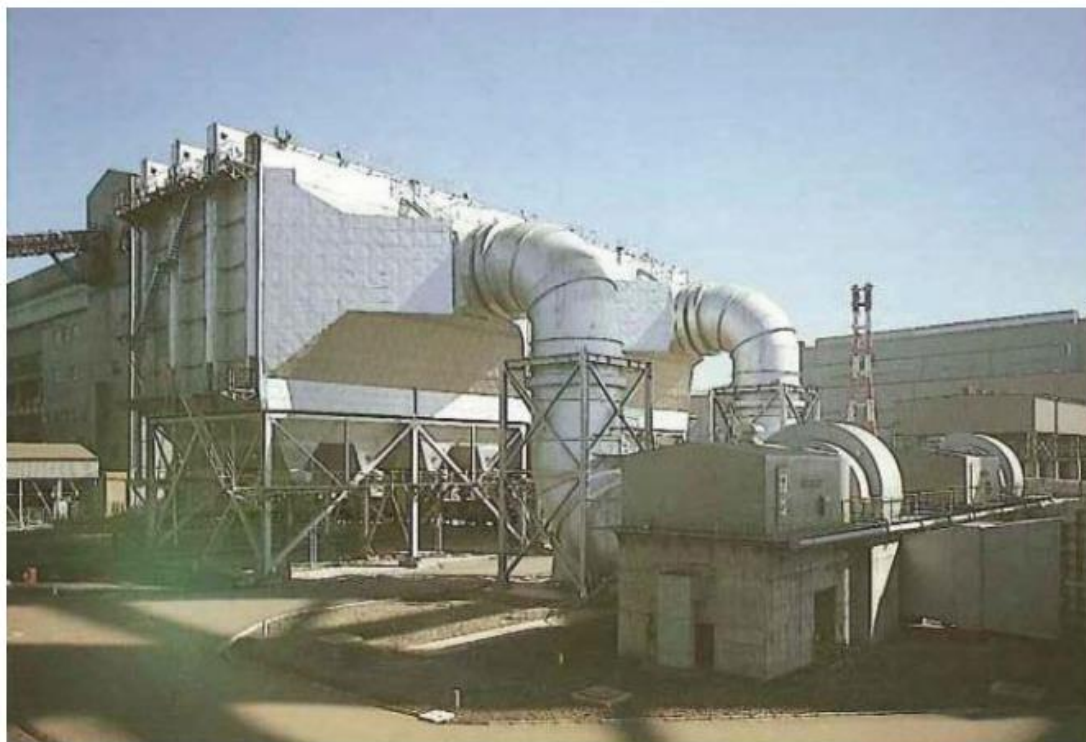
شکل ۱: نمایی از رسوب دهنده های الکترواستاتیک
