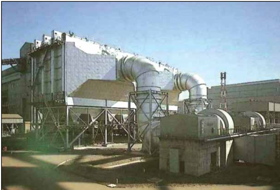
شکل ۱: نمایی از رسوب دهنده های الکترواستاتیک (ESP)
